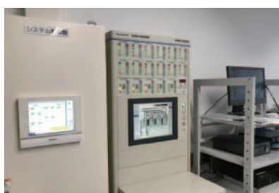
写真2 中央監視・制御装置
