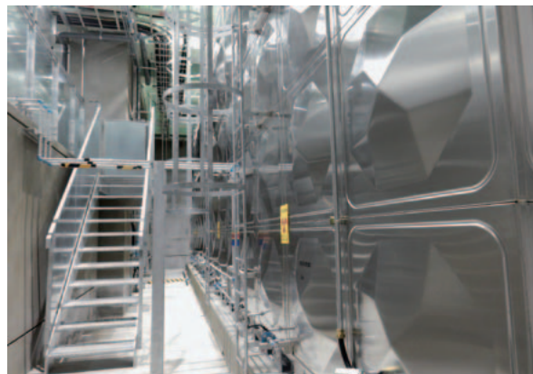
写真 3 80m³の貯留槽および希釈槽
