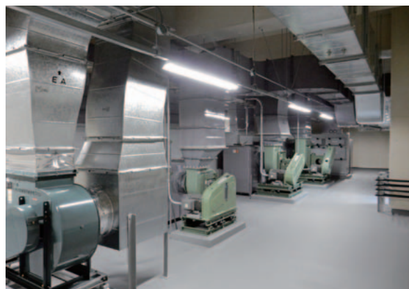
写真 7 4階屋内の排気設備室
