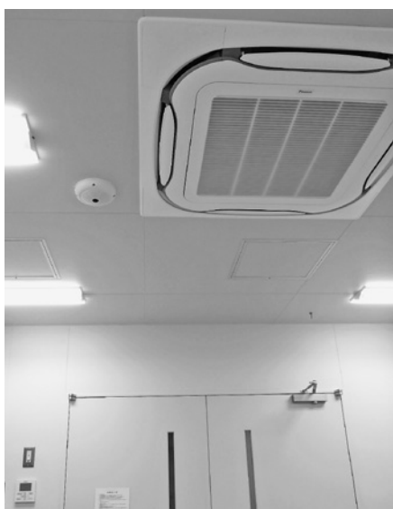
写真8 各部屋に設けられたエアコン 壁のコントローラーで好みの温度に設定できます。
