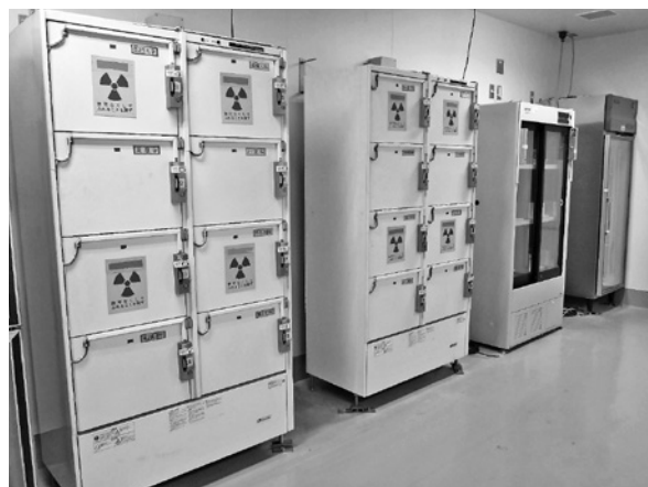
写真 5 貯蔵室 各冷蔵庫等の扉の電気錠はシステムによって管理されます。
