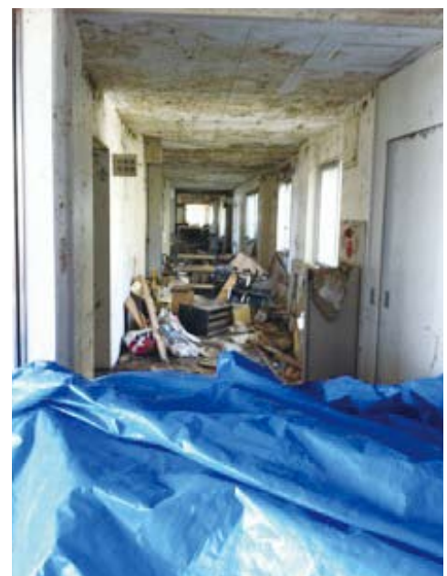
津波被害を受けた小学校の様子
