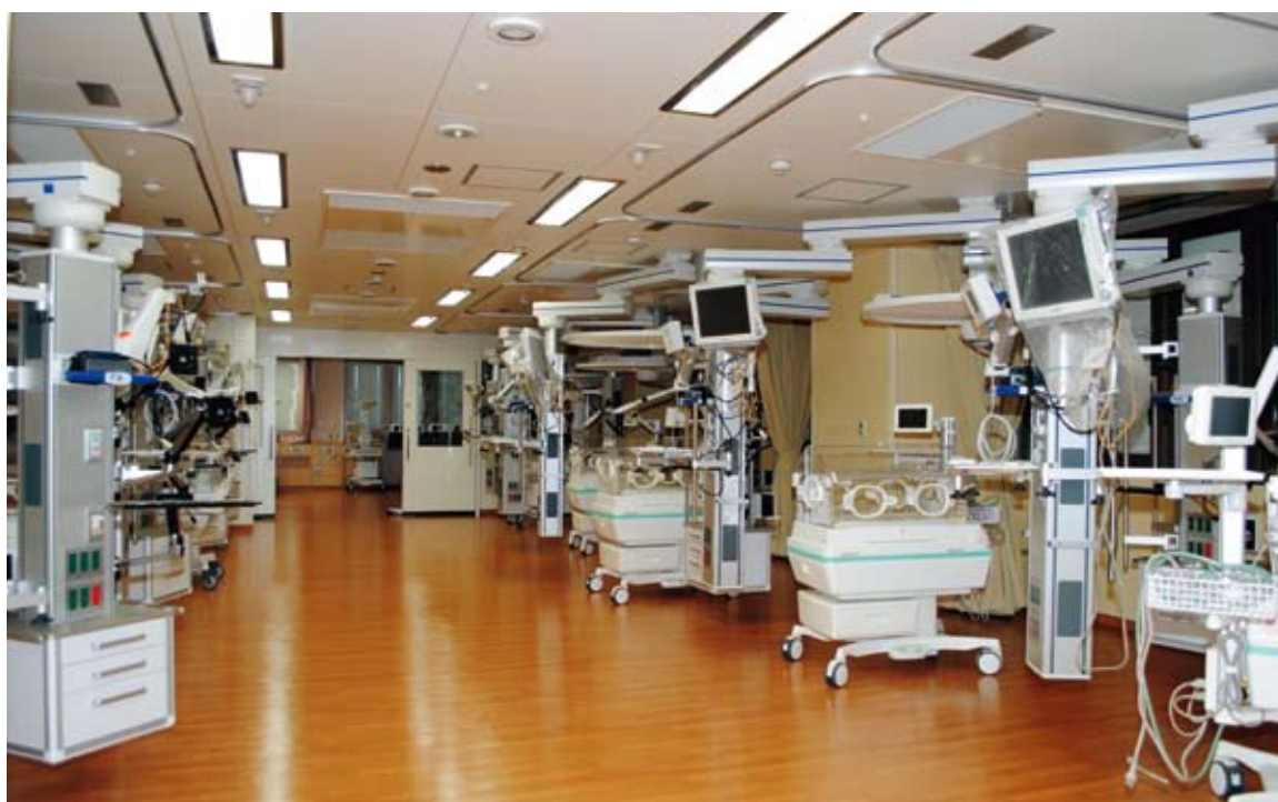
NICU(新生児集中治療室)です。NICUは重症新生児を治療するところです。NICUでは重症管理をするため厳しい雰囲気になりがちなので、床面はフローリング調、壁は薄い黄色として柔らかな空間となるように工夫をしました。
