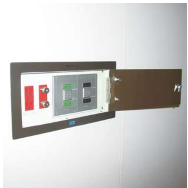
医療用ガス設備
